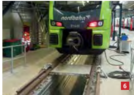
6. Gleisplatten, 2 Stück zum sicheren Überqueren der Gleisgruben
